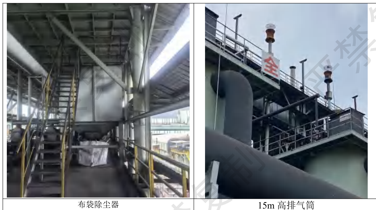
图 4.1-3 含煤粉尘处理设施建设情况
